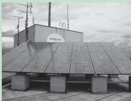
庁舎屋上に設置された太陽光発電設備
