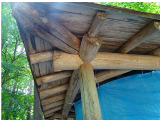
柱・梁の確認（劣化）
