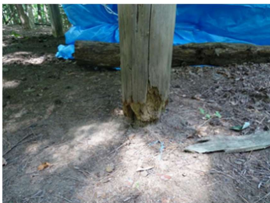
基礎の確認（腐朽）
