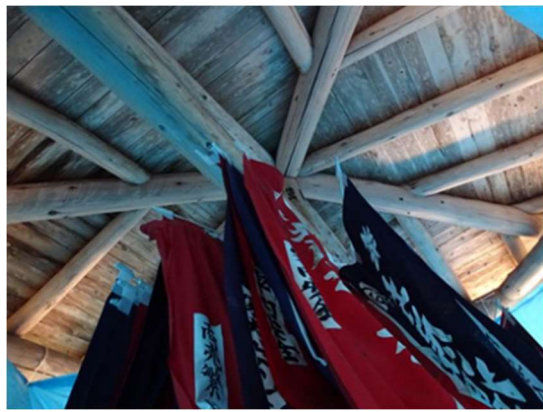
天井の確認（劣化）
