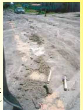
平成12年の有珠山噴火により、火山灰におおわれた道路の様子
