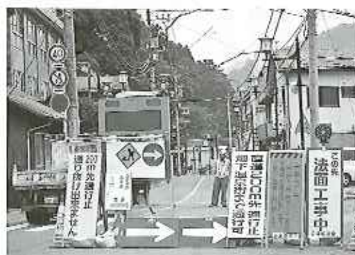
国道400号通行止め（八汐橋付近）
