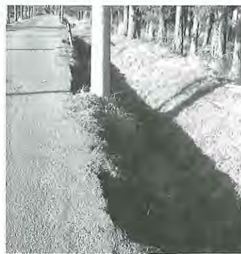
集中豪雨により路面が洗掘されている日の出2号線
