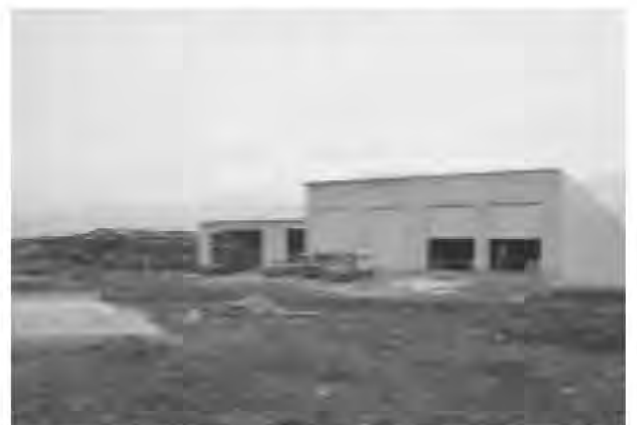
来年度の稼働に向け建設が進められている堆肥センター
