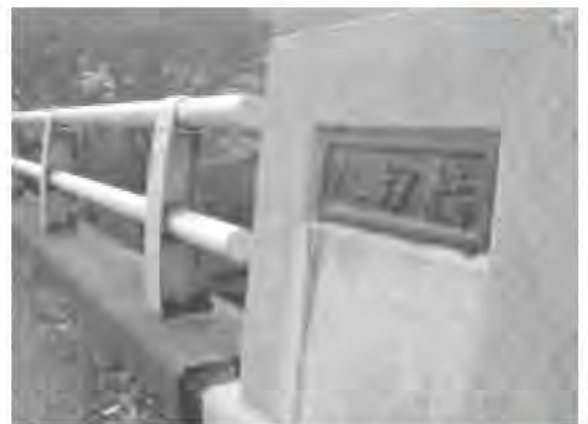
欄干の高さを満たしていない八汐橋
