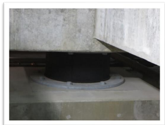
免震装置（福島県喜多方市役所）
