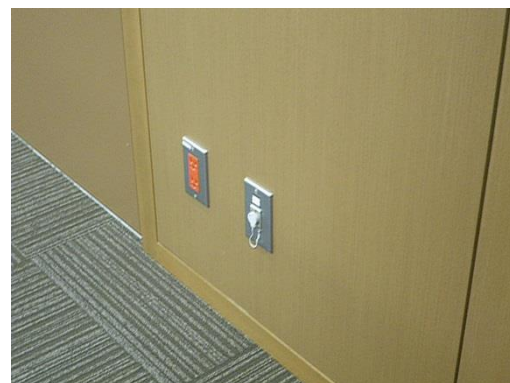
非常用電源設備 (東京都青梅市役所)
