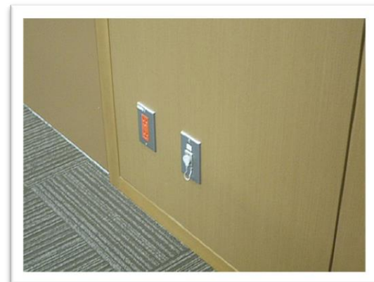
非常用電源設備（東京都青梅市役所）
