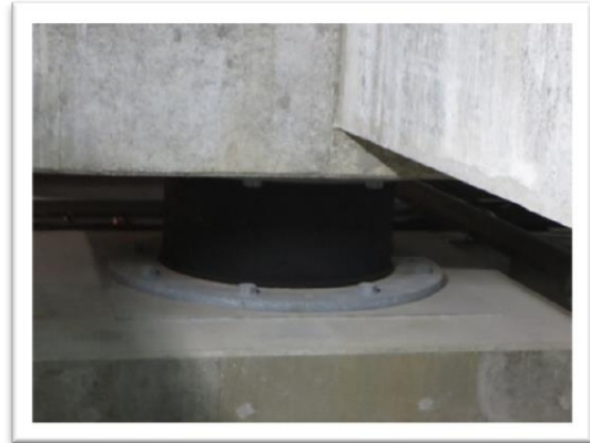
免震装置（福島県喜多方市役所）
