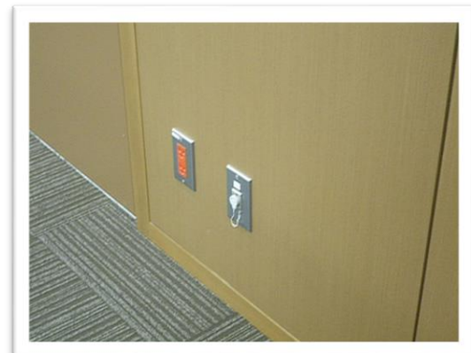
非常用電源設備（東京都青梅市役所）
