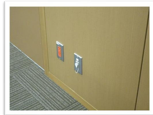
非常用電源設備（東京都青梅市役所）
