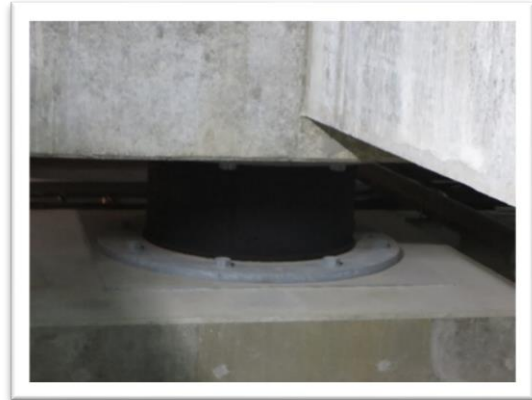
免震装置（福島県喜多方市役所）
