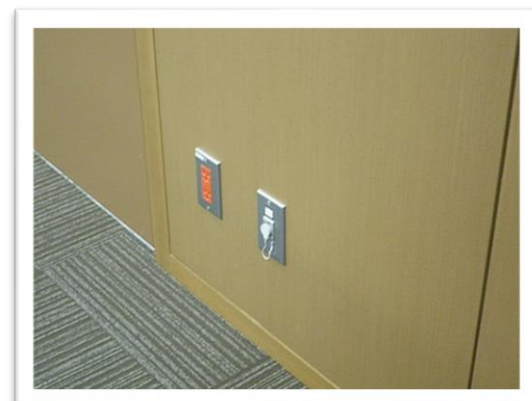
非常用電源設備（東京都青梅市役所）
