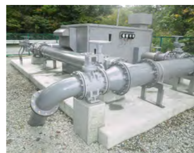
鳥野目浄水場に設置している小水力発電システム
