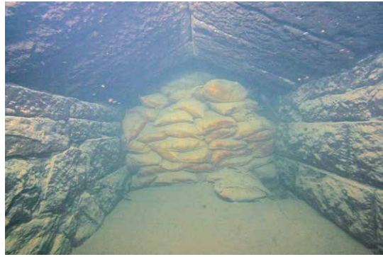
第一次・第三次取入口を隧道の中から見たところ。内側から土のうでふさがれている。
