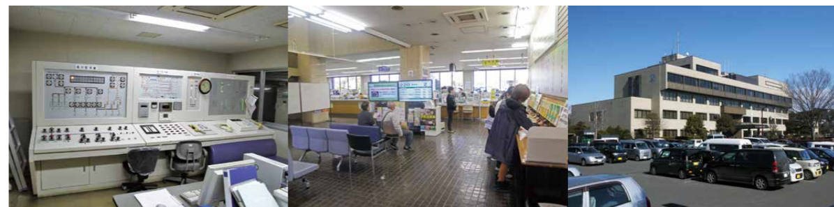
電気や空調の設備も老朽化が進む 窓口から離れた待合コーナー 多くの車で込み合う駐車場
