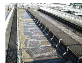
エアレーションタンク
