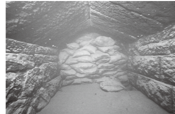
東隧道土質閉塞状況(東水門内側)
