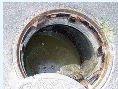
汚水があふれそうなマンホール
