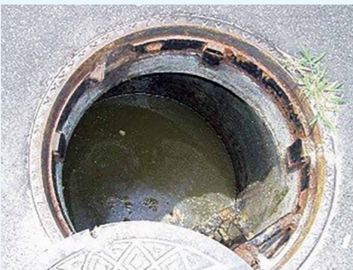
汚水があふれそうなマンホール
