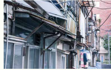
適切に管理されていないと、倒壊の危険性や景観の悪化など、周囲の環境への悪影響が懸念される
