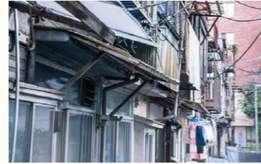
適切に管理されていないと、倒壊の危険性や景観の悪化など、周囲の環境への悪影響が懸念される
