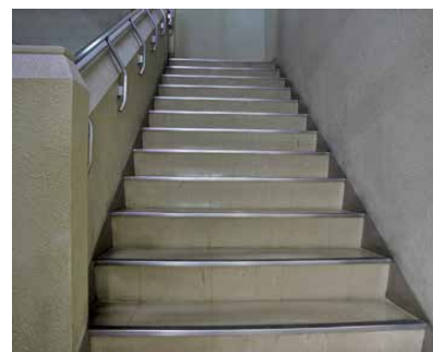
↑階段の段差が高く、高齢者などにとって使いにくい状況
