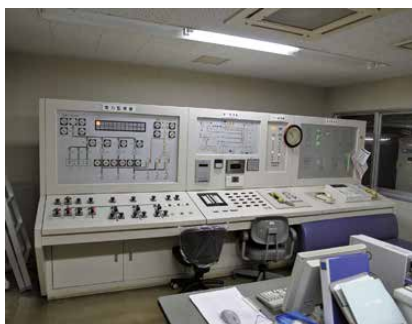
↑地下1階にある電力・動力の監視室。省エネに配慮した設備が求められます
