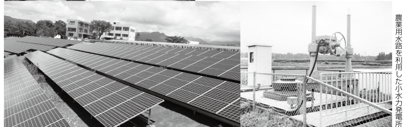
那須野ヶ原土地改良区連合の敷地に設置されたソーラーパネル
