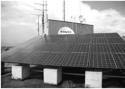
市役所本庁舎屋上の太陽光パネル
