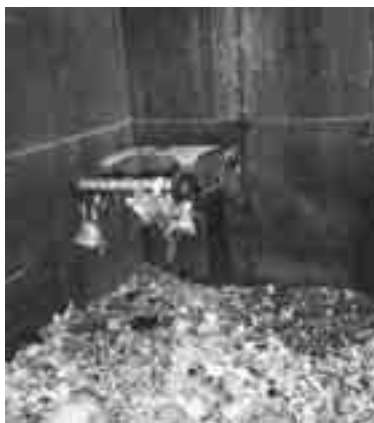
ごみクレーン車でかき回す
