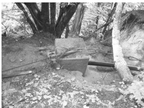
新湯簡易水道の導水施設
