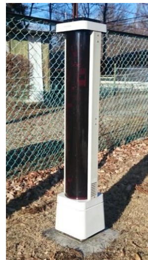
図 3.7 鳥野目浄水場第一水源沈砂池に設置された侵入検知センサー
