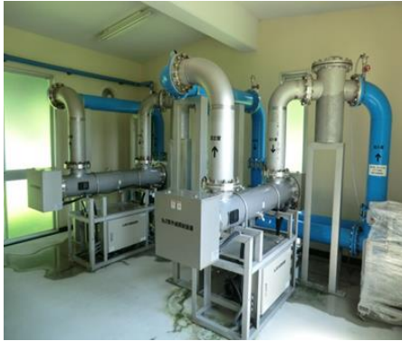
紫外線処理（中山配水場）
