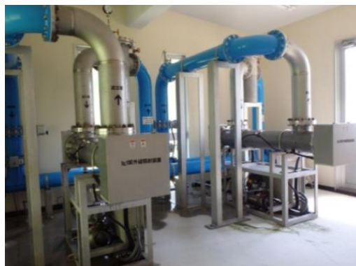
図 3.1 紫外線処理設備（中山配水場）
