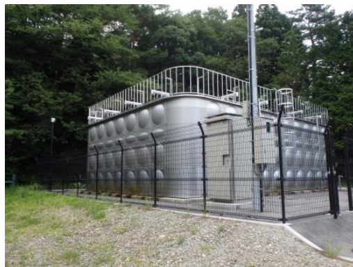
(板室本村低区配水池)
