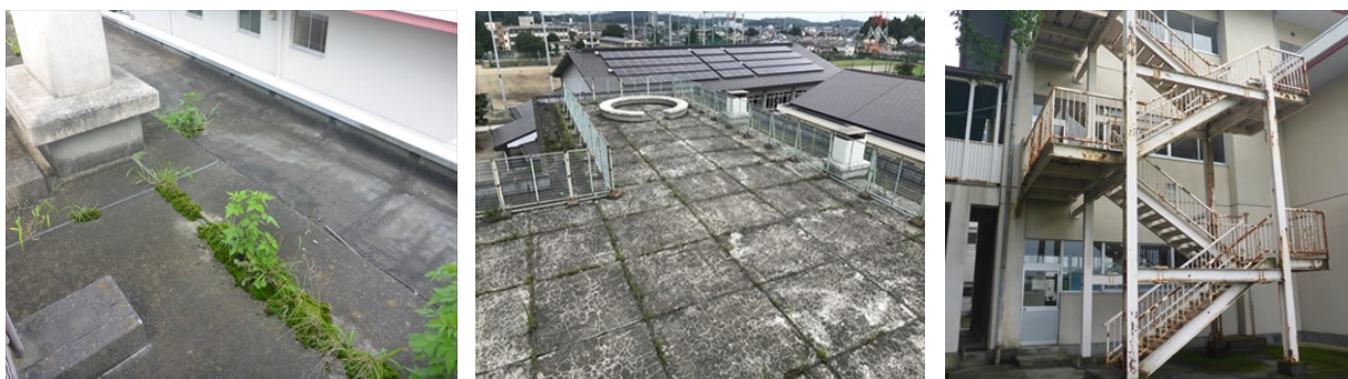
屋上目地材の劣化
