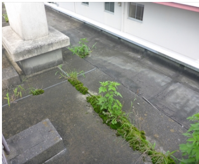
屋上目地材の劣化
