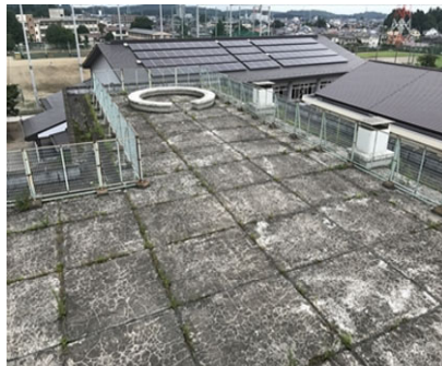
屋上保護層の劣化
