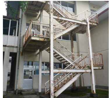
外部階段の劣化
