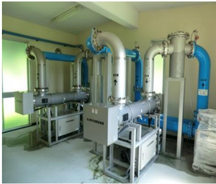
紫外線処理（中山配水場）
