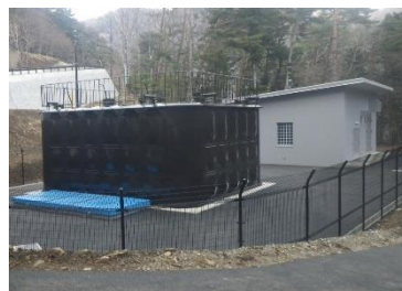
塩の湯ポンプ場
