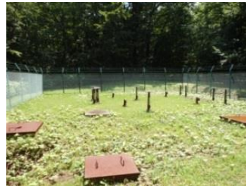
新湯第2配水池
