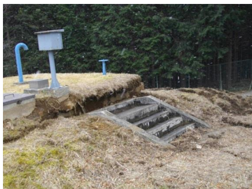
(熊久保配水池)
