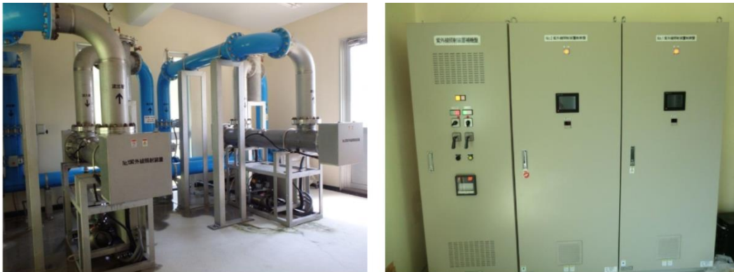
図 3.1 紫外線処理設備（中山配水池）
