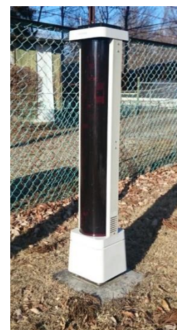
図 3.7 鳥野目浄水場第一水源沈砂池に設置された侵入検知センサー
