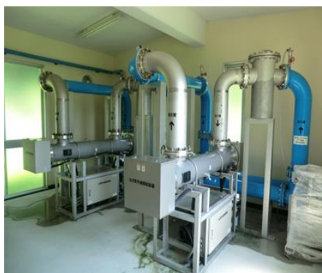
紫外線処理（中山配水池）
