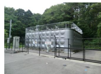
板室本村低区配水池
