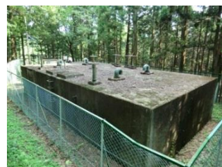
宇都野配水池
