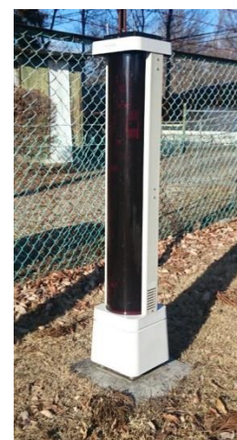
(鳥野目浄水場第一水源沈砂池に設置された侵入検知センサー)
