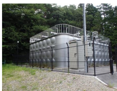
(板室本村低区配水池)
