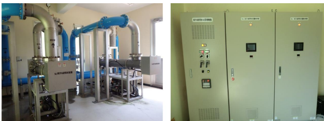
図 3.1 紫外線照射装置（中山配水池）
