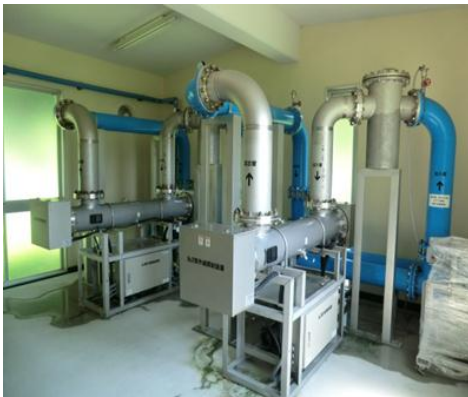
中山配水池 紫外線処理 注3
