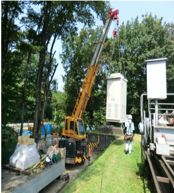
災害に強いシステムの構築（施工中） 小水力発電設備（鳥野目浄水場）
