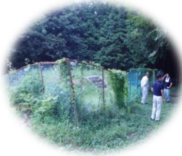
老朽化した防護柵 昭和54年築造 （熊久保配水池）
