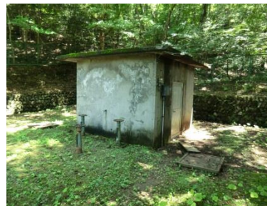
老朽化した施設 昭和35年築造 （須巻配水池）
