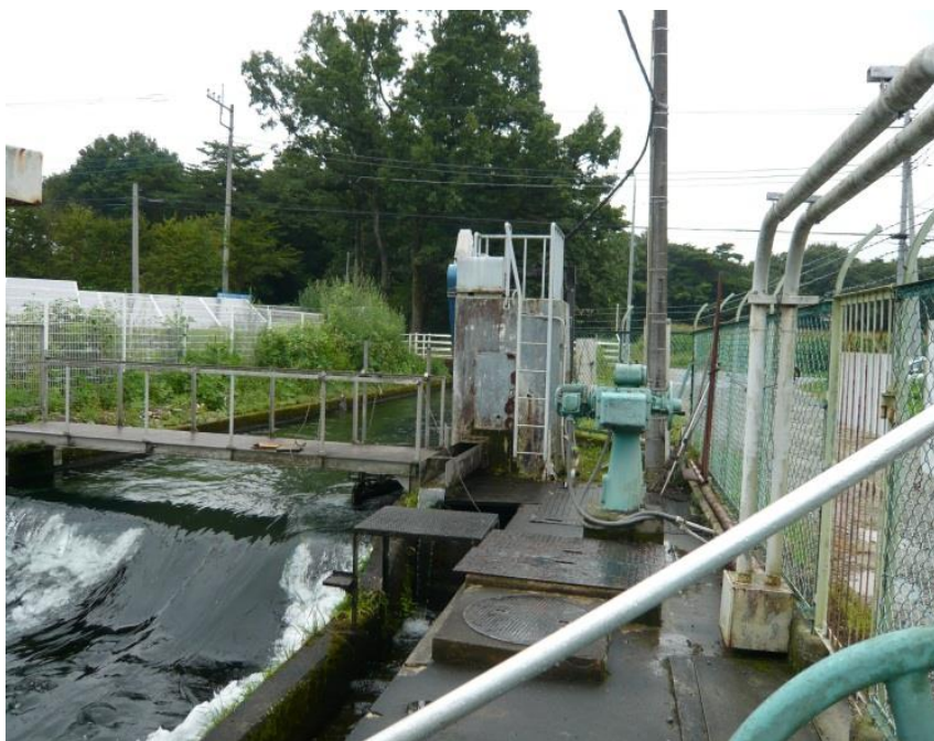
千本松浄水場への取水口上の除塵機 ここからいよいよ浄水場に送られます
