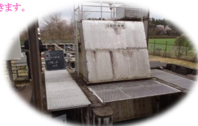
鳥野目浄水場への導水路（沈砂池）上の除塵機
