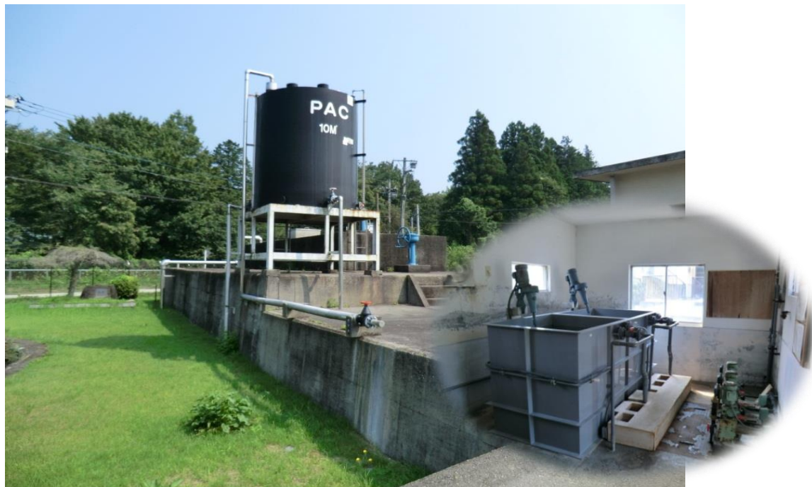
ポリ塩化アルミニウム（PAC）貯蔵タンク と薬品注入ポンプ（千本松浄水場）
