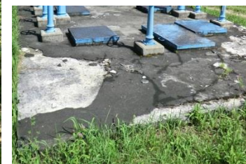
老朽化施設 昭和44年築造 （要害配水池）
