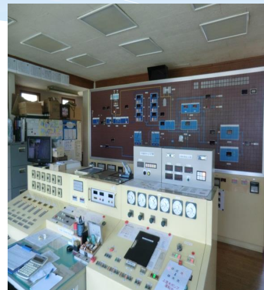
監視室（千本松浄水場）
