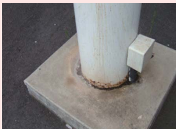
ポールの根元にサビが発生
