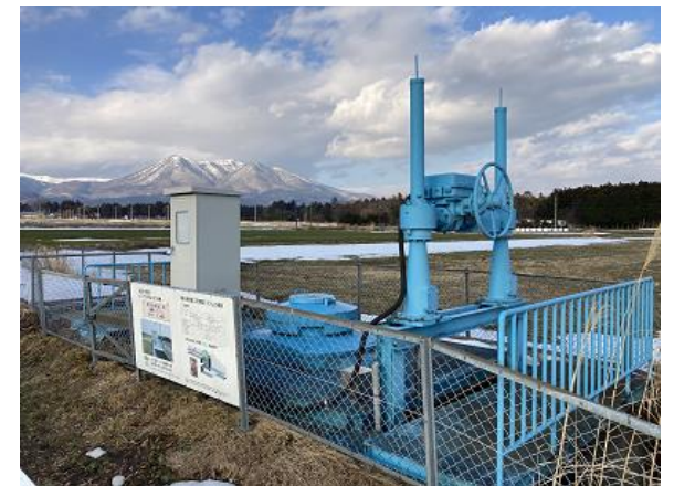
百村の小水力発電施設
