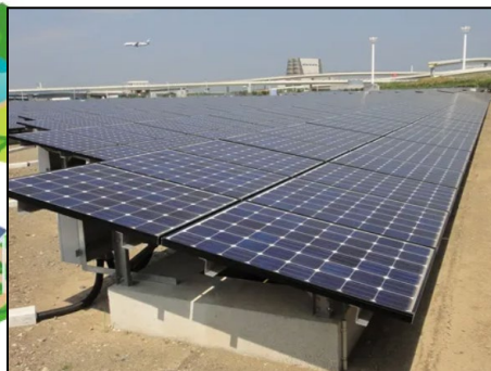
地上設置型太陽光発電の事例 (東京電力リニューアブルパワーHP)
