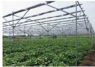
露地の畑の上部にパネルを設置
