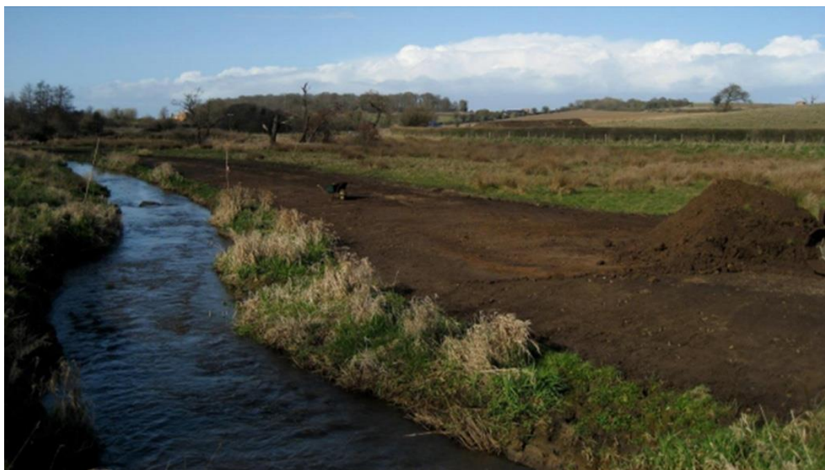
図 7-4-2(1) 堤防の撤去作業（A-PLAT 気候変動適応情報プラットフォーム） 1)
