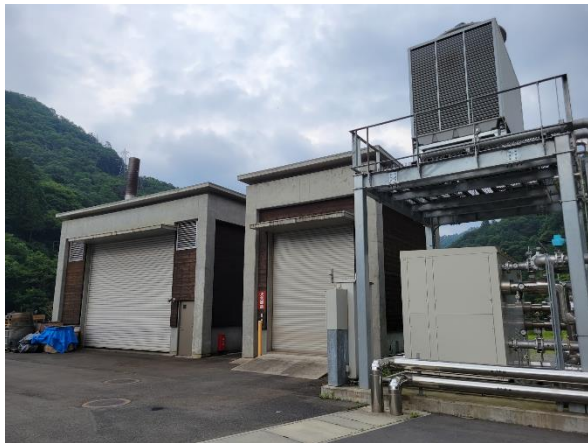
バイオマス発電所
