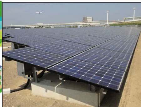
地上設置型太陽光発電の事例 (東京電力リニューアブルパワーHP)
