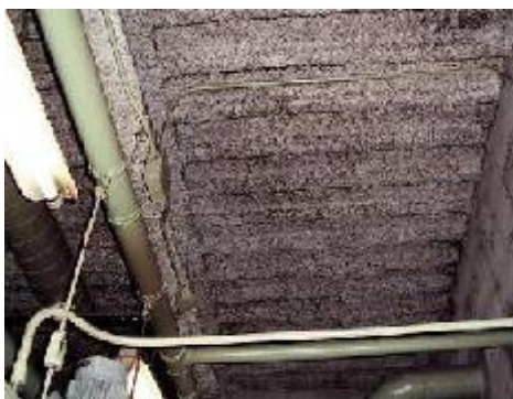
石綿含有吹付けロックウール
