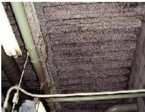
石綿含有吹付けロックウール
