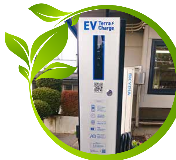
▲市有施設に設置している 電気自動車用充電設備
